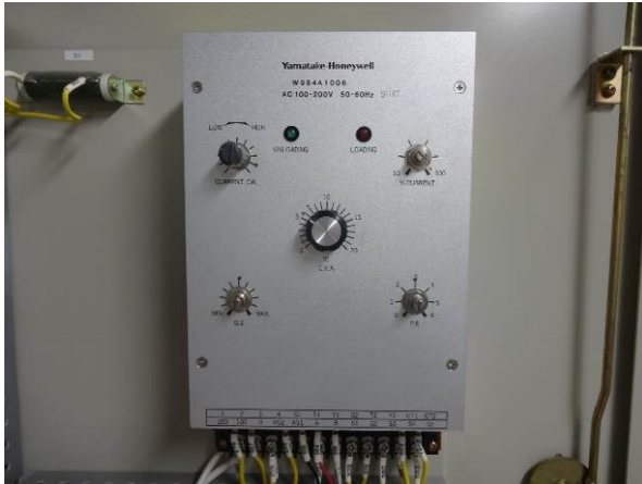
更新前の温度調節器
