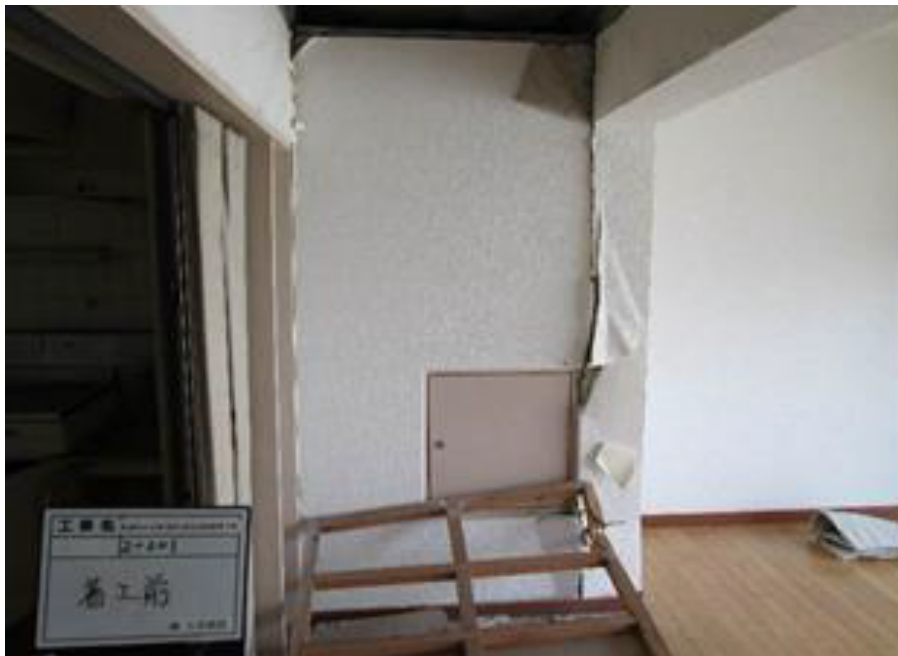
写真 2.10.1.(6)-2 建家内部被災状況
