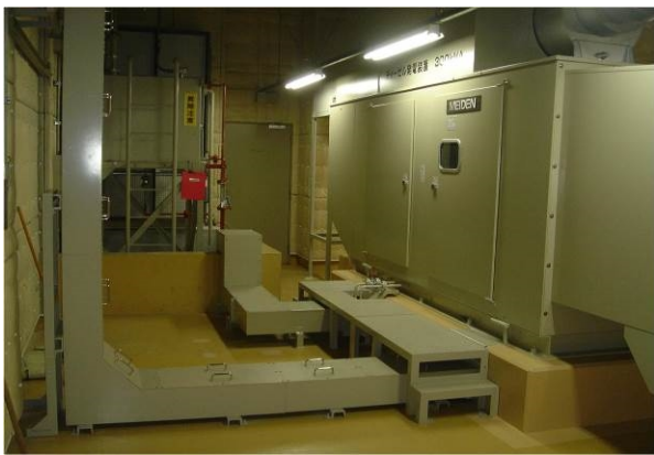
更新前の非常用発電機
