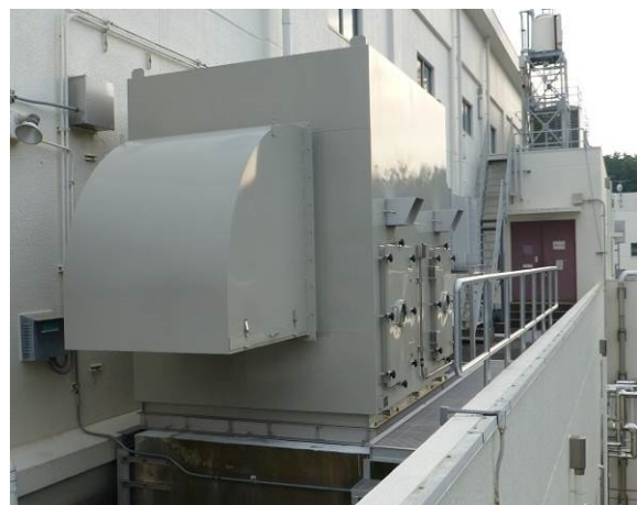
更新後(除塩給気フィルタ式)
