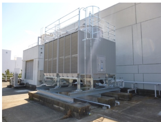
冷却塔更新後
