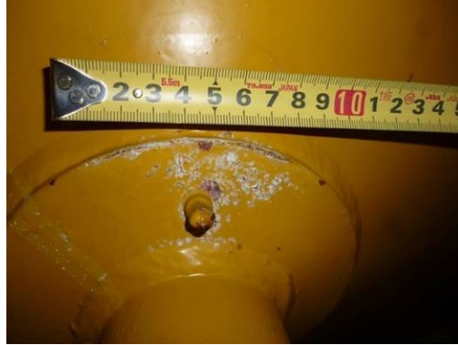
写真 2. 1. 6-1 No. 2 廃液貯槽の塗装剥離箇所
