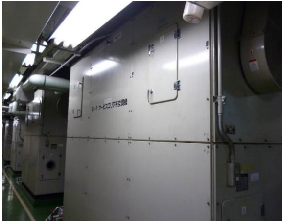
給気第4系統空調機全景
