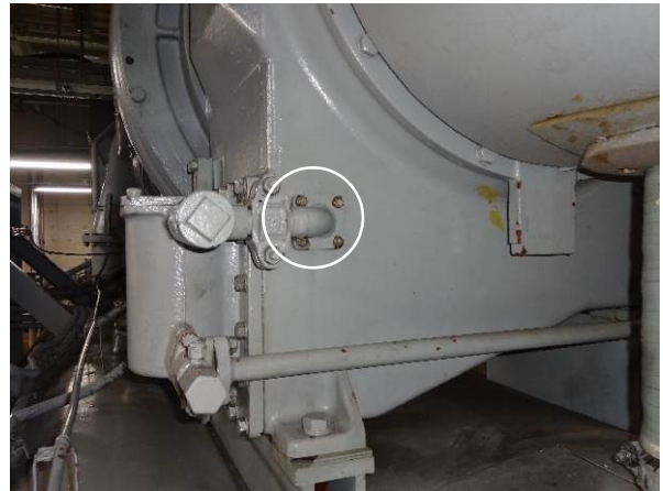
空気混入箇所：丸の部分
