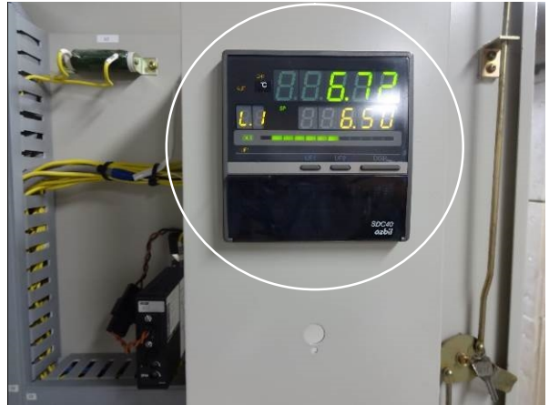
更新後の温度調節器（丸の部分）
