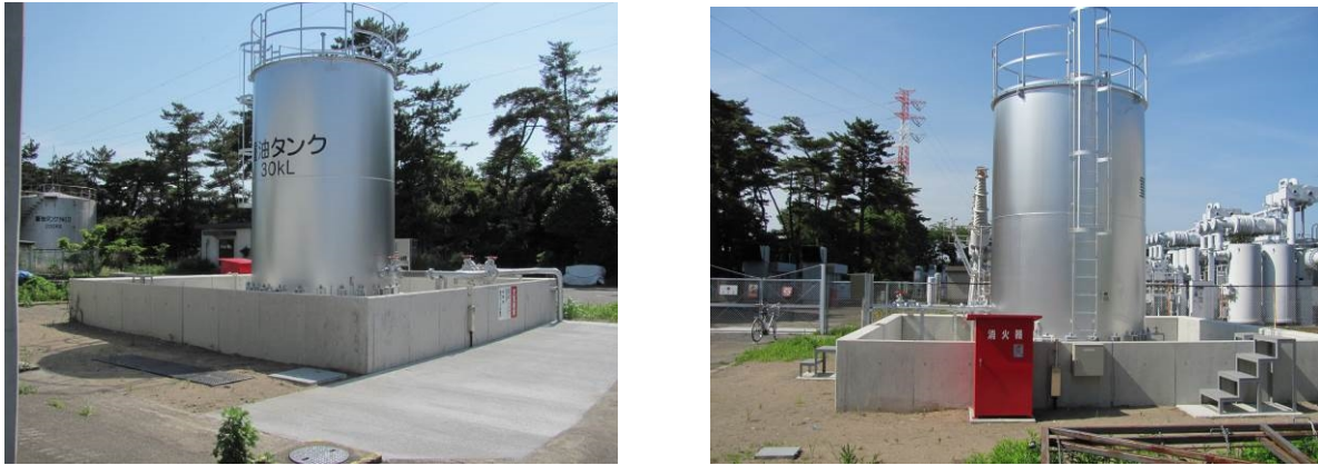
写真 2.10.1(3)-1 緊急時重油備蓄タンクの外観
