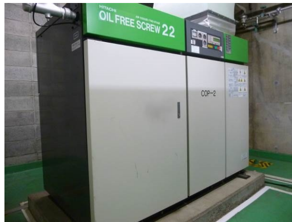
写真 2.1.8-1 空気圧縮機No.2 外観
