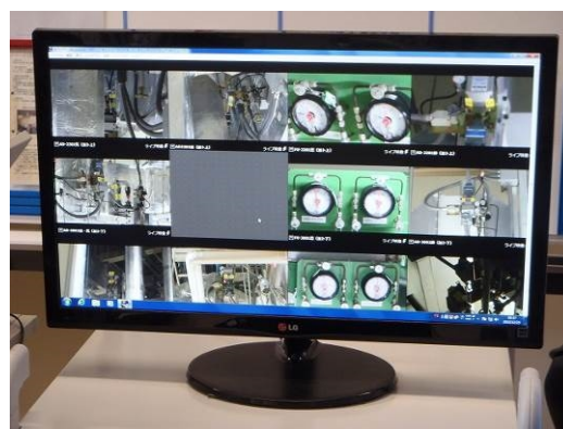
中央制御棟設備コントロールの監視画面
