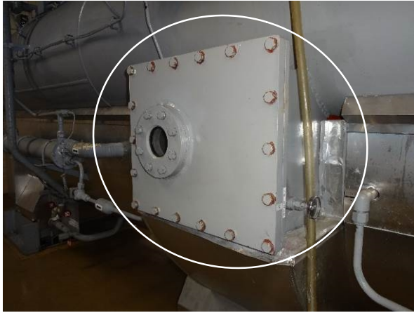
空気混入箇所：丸の部分
