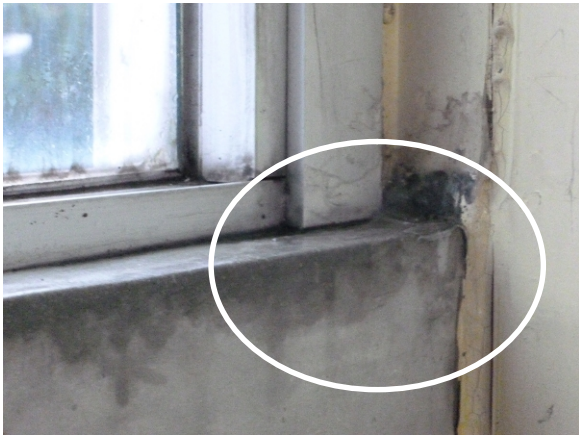
雨水が浸水した窓枠(拡大)
