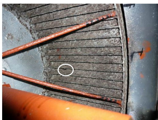
シロッコファンの羽根板の腐食箇所
