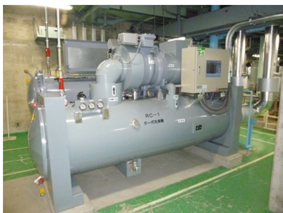
ターボ冷凍機更新後
