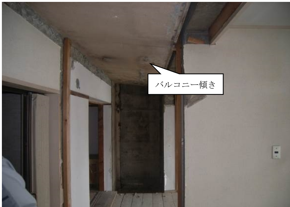
写真 2.10.1.(6)-5 天井裏バルコニー改修前
