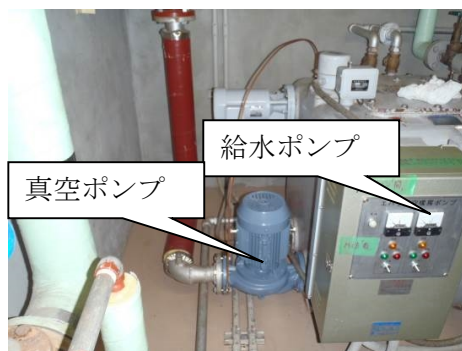
写真 2.1.1-2 暖房用真空ポンプ及び給水ポンプ（更新後）
