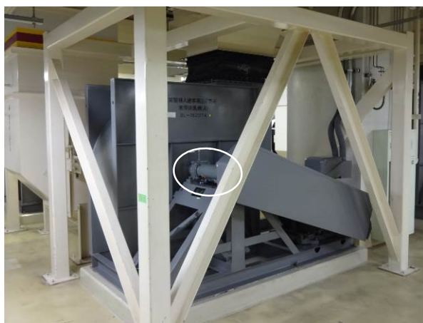
排風機 A 号機の全景
