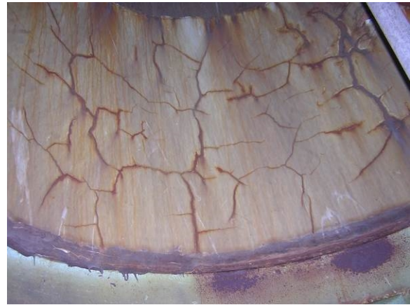
排気筒内部クラック及びシーリング劣化状況
