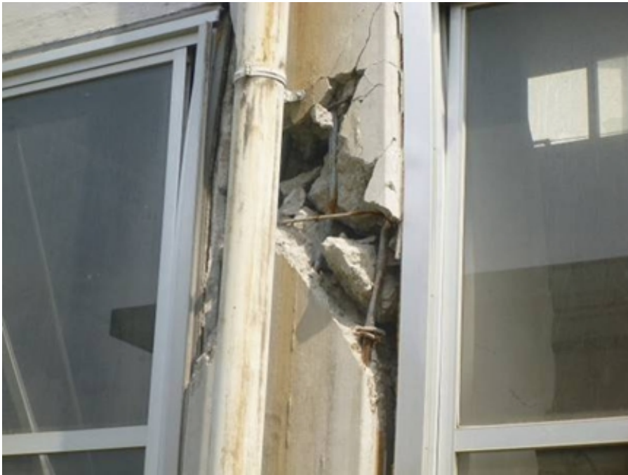
写真2.10.1(5)-1 主筋のせん断破壊・座屈・コンクリート剥落
