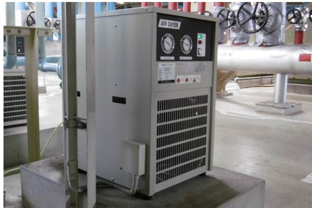
写真2.1.12-2 更新後除湿器
