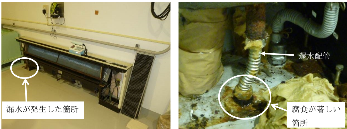
ファンコイル全景 (前カバーを外したところ)
