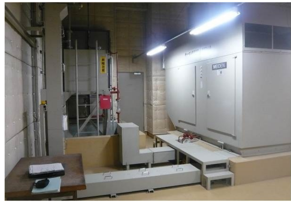
更新後の非常用発電機
