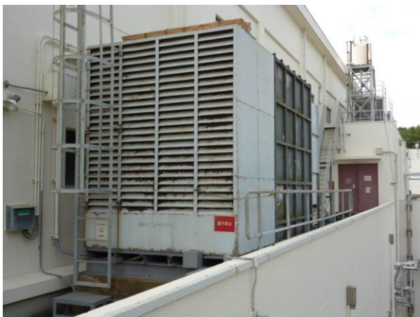
更新前(水噴射空気洗浄式)
