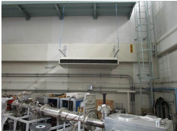
写真 2.1.11-1 更新後の空調機
