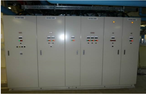
空調系統動力制御盤
