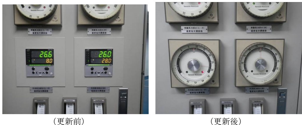
写真 2.1.1-1 JRR-3 実験利用棟共用系空気圧縮機の温度調節器
