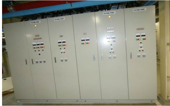
排気系統動力制御盤
